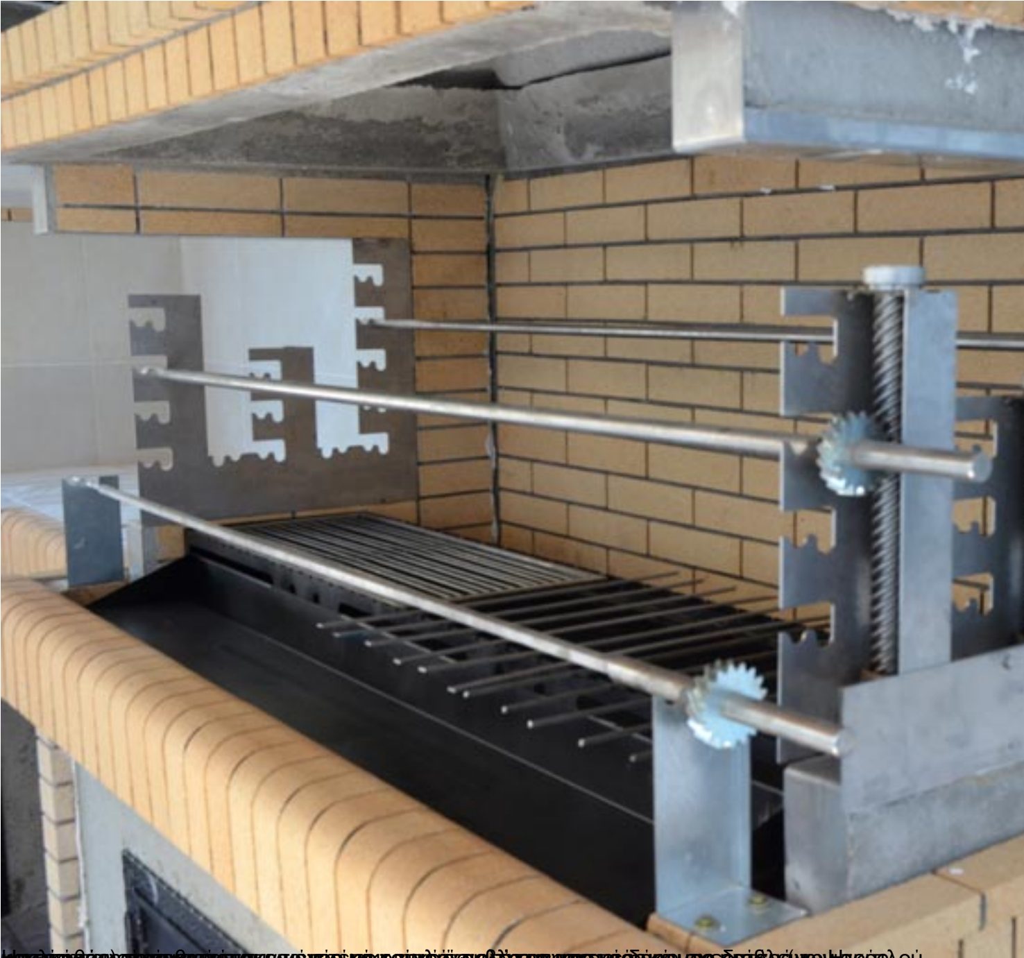
Η φωτογραφία απεικονίζει την εσωτερική δομή της ψηστικής φούρνου, που αποτελείται από τούβλα και μεταλλικά στοιχεία, όπως το πλέγμα και ο μηχανισμός περιστροφής.
